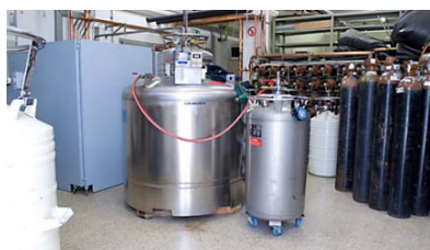
Instalaciones de la sección de criogenia
