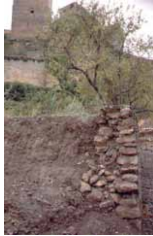
Fig. 12. Muro de contención de los años ochenta, con cara externa, relleno de cascos pero sin cara trasera. Alcalá la Real.
