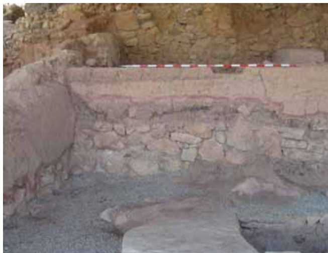
Fig 7. Consolidación de muros de tapial y restitución de los mismos (sin superar la cota original) separando con la línea de pintura roja-almagra la zona restituida de la original.
