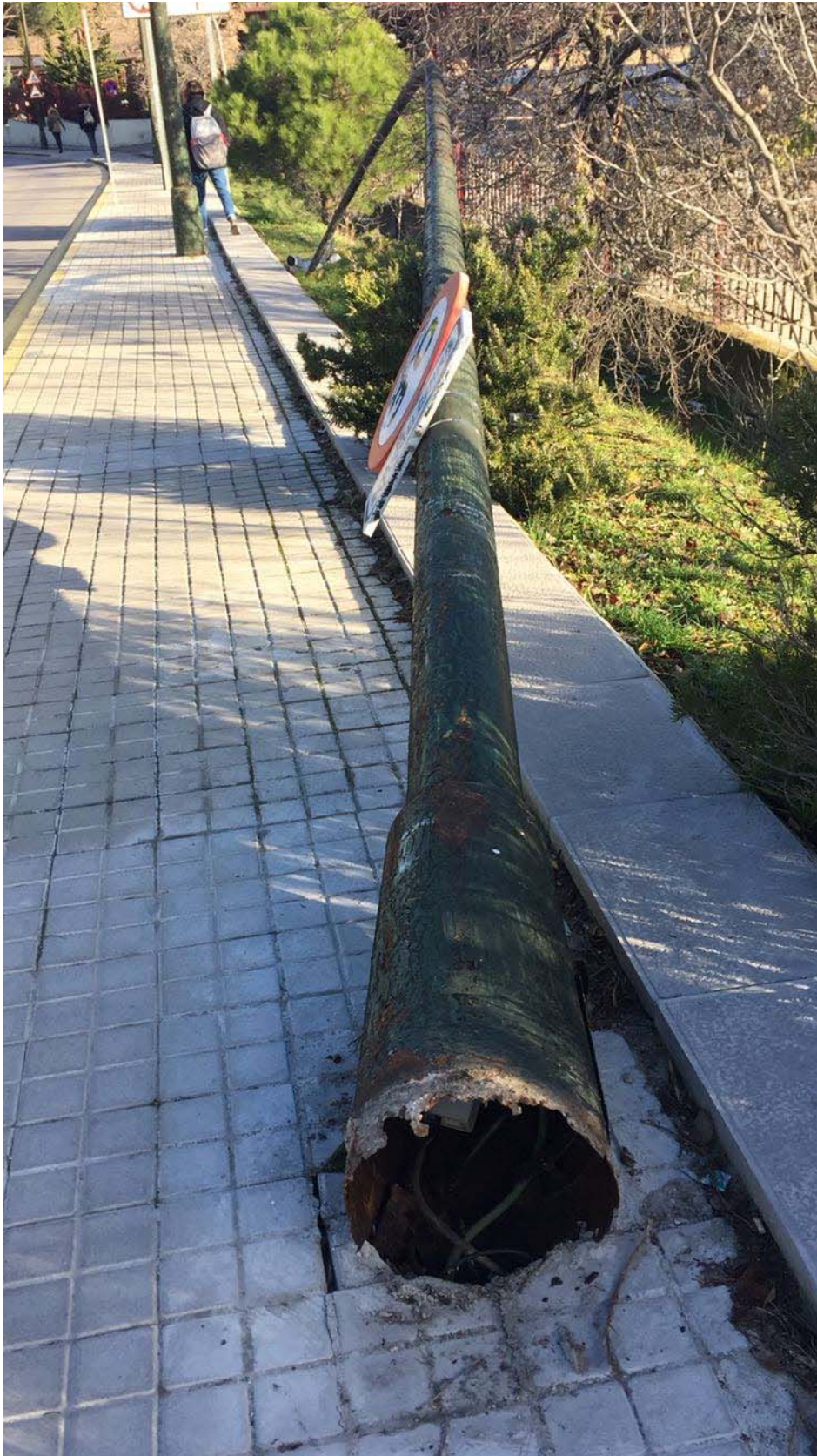
Fotografía 2: báculo partido en la base por la oxidación.
