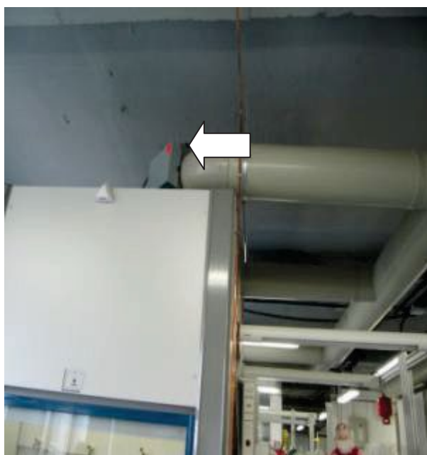
Foto 2. Regulador de caudal
