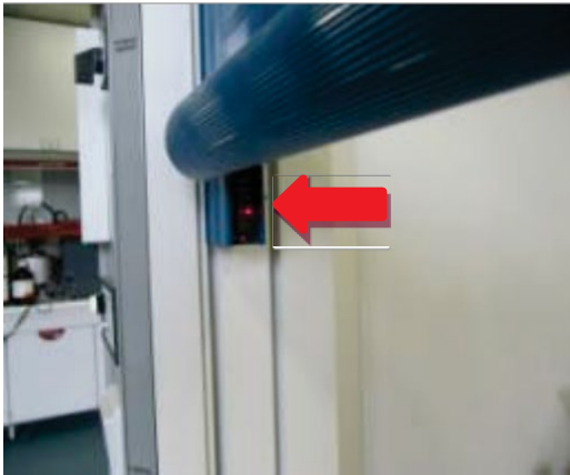
Foto 3. Detector de presencia en la parte inferior de la guillotina
