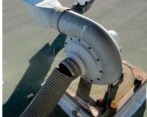
Foto 6. Rotura de un conducto de extracción junto al motor de extracción
