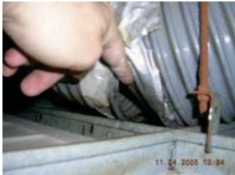
Foto 7. Rotura de conductos en el techo del laboratorio
