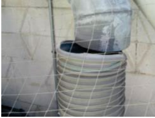
Foto 5. Rotura de un conducto de extracción en el exterior del edificio
